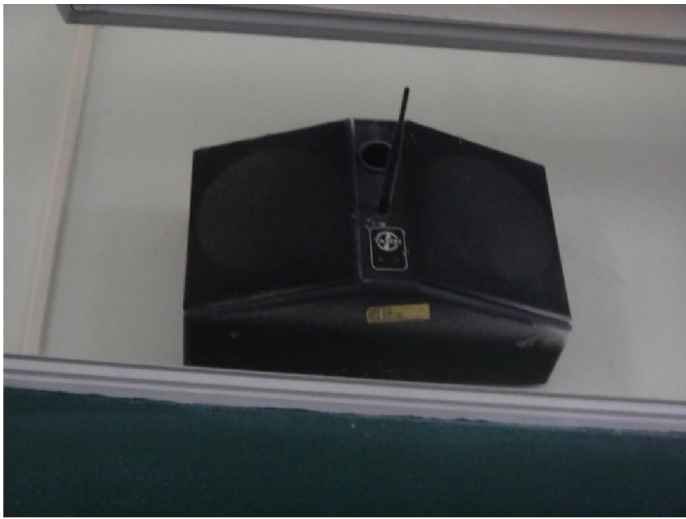
無線麥克風設備
