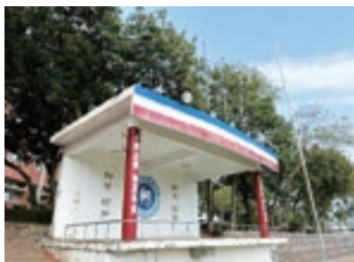
舊有司令台斑駁、水泥塊崩落
