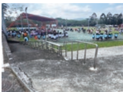
舊有坡道鋪面斑駁
